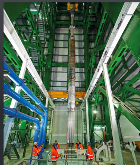
Das ehemalige Bergwerk Walsum ist der erste Standort im Ruhrgebiet, der mit der neuen Pumpengeneration ausgestattet wurde.
